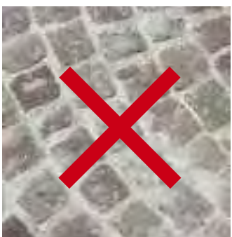
Kein Zementschleier Aucun voile de ciment Non velo di cemento
